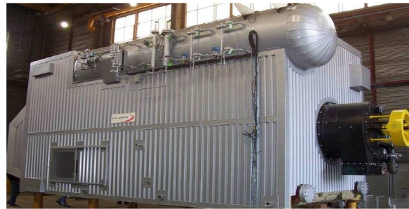
Figure 7 Une chaudière à tube d'eau.
