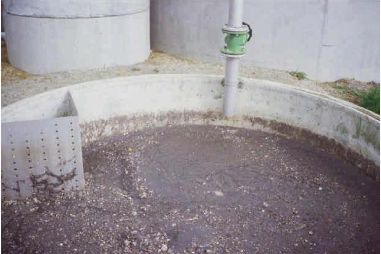
Extraction du sable d'un dessableur
