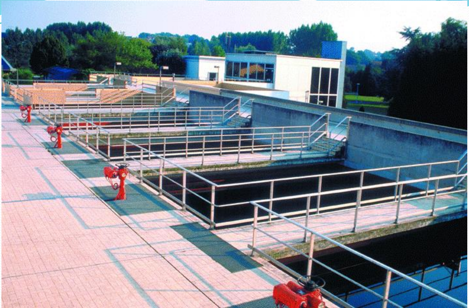
Installation de MOULLE (Pas-de-Calais) pour la Lyonnaise des Eaux. Débit: 2\,000\text{ m}^3\cdot\text{h}^{-1} . Batterie de 7 filtres MÉDIAZUR V pour CAG.
