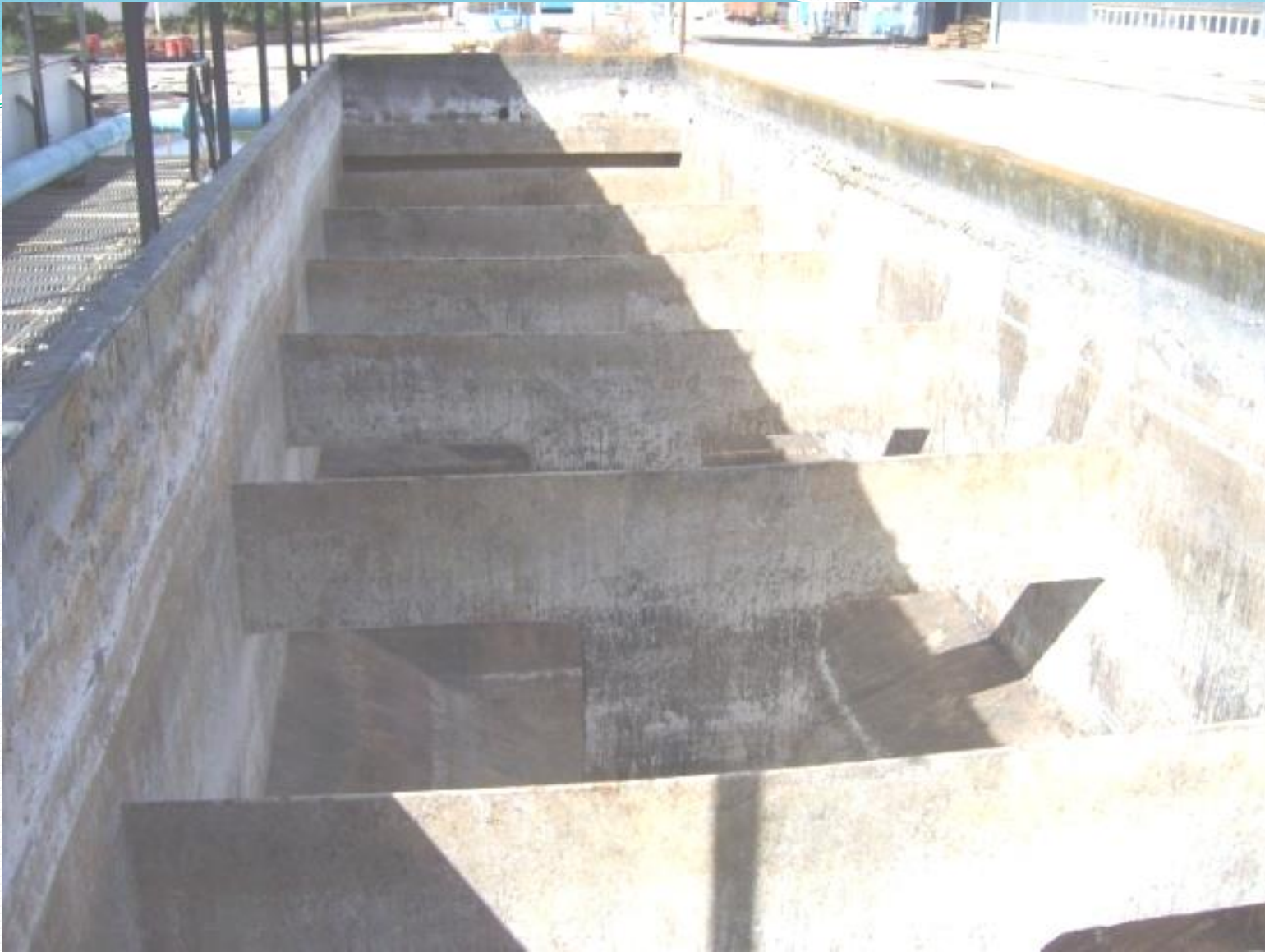
Décanteur statique à plusieurs compartiments
