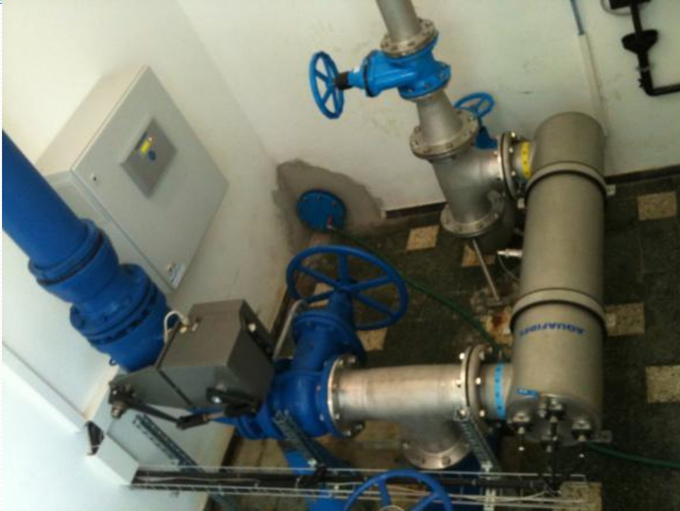
Installation de désinfection par UV
