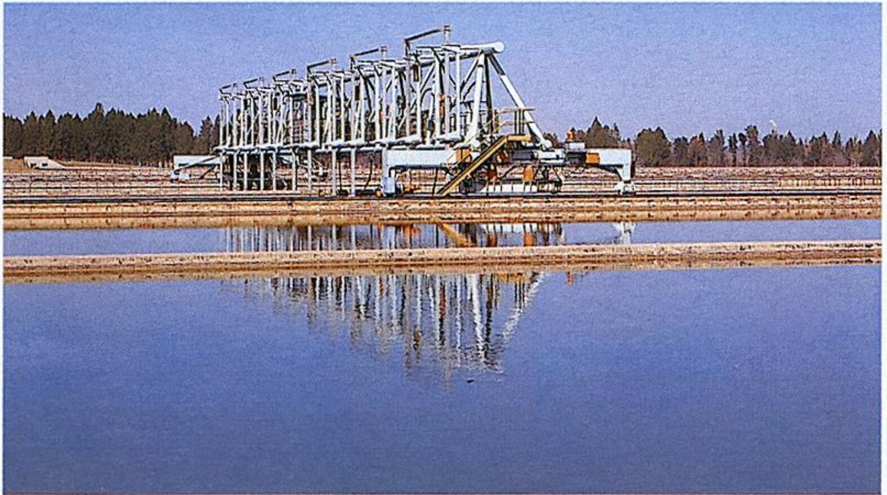
Décanteur à pont transbordeur (4 fois 50 m X 200 m).
