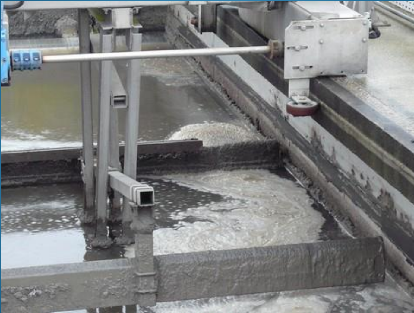
Dessableur /déshuileur de la station d'épuration de Béthune ( Pas de Calais).
