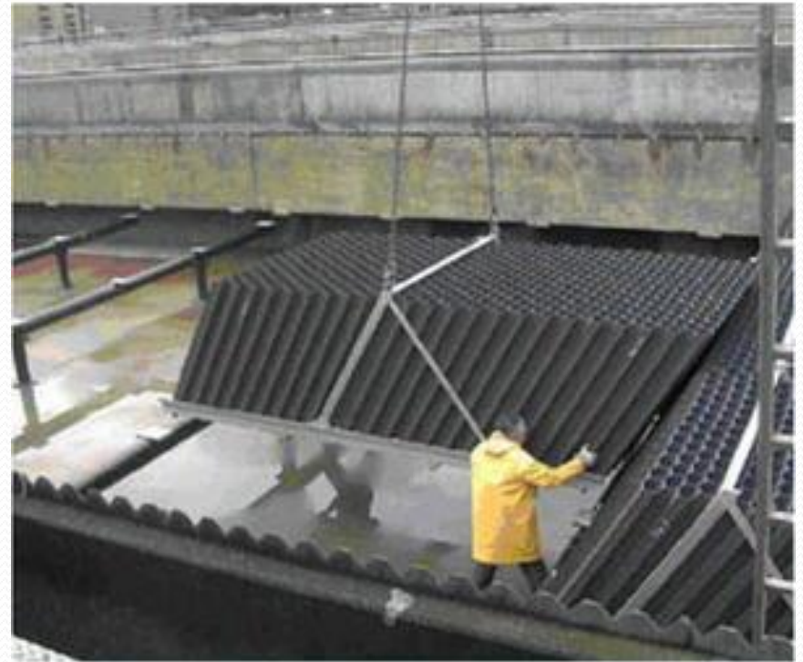
Décanteur à tubes fortement inclinés
