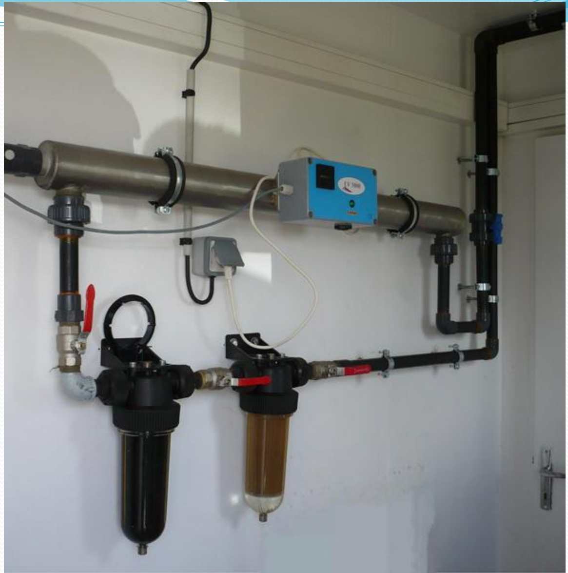
Installation de désinfection par UV
