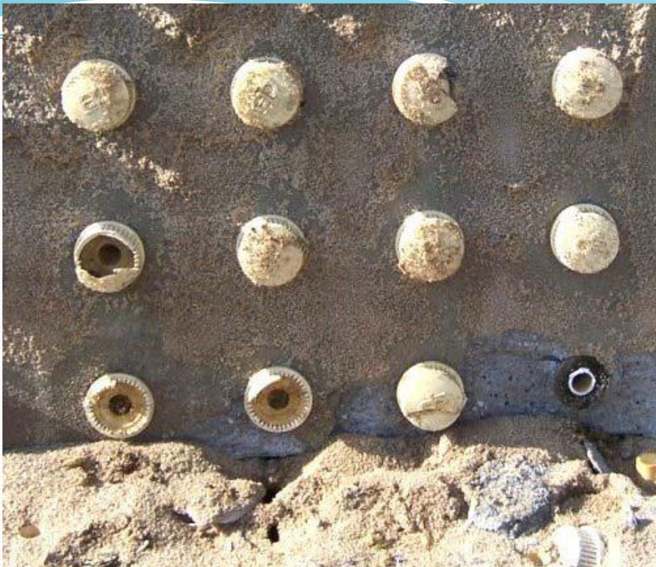
Busettes PVC détériorées
