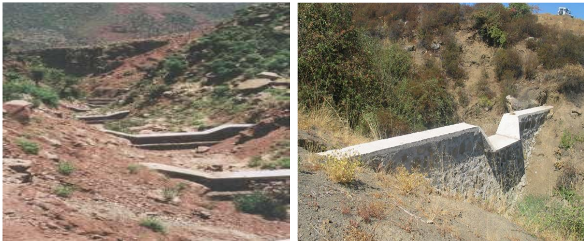
Photo 13: Seuils en pierres cimentées (HCEFLD, 2014).
