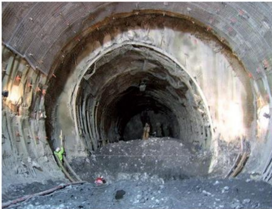
Figure 7: Déformation plastique des cintres (Galerie de Saint-martin-la-Porte : Reprofilage avril 2006)
