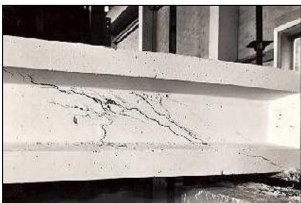
Rupture de poutre par effort tranchant près de l'appui
