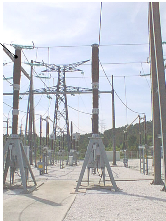
---- disjoncteur 63 kV au SF6 ----
