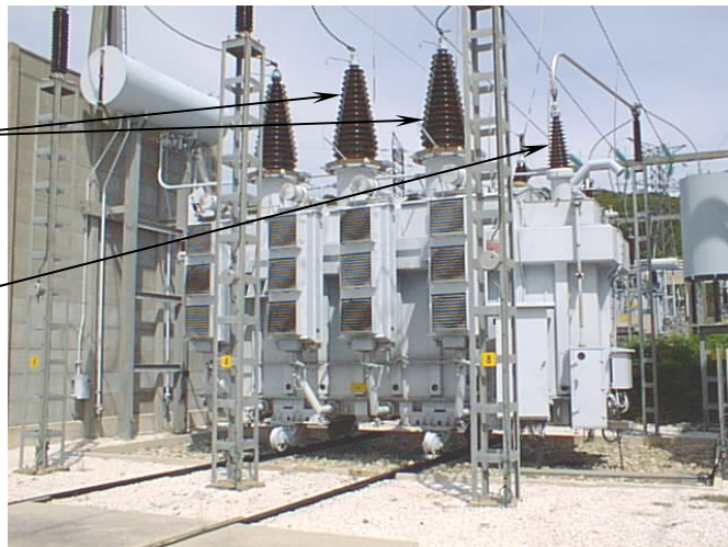
--- Transformateur 225/63 kV immergé dans l'huile ---
