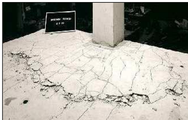
Des efforts concentrés, comme près des colonnes, peuvent provoquer une rupture de la dalle par poinçonnement
